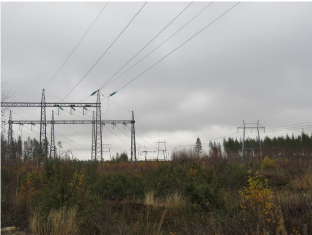
Kuva 23. Pirttikankaan sähköasema, koilliseen.
