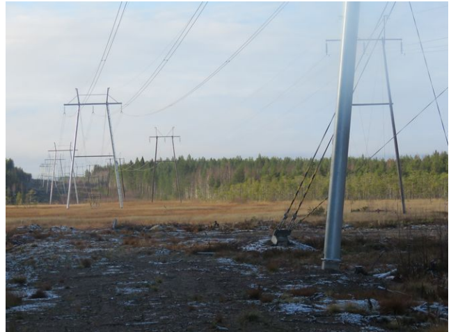
Kuva 10. Pyhäjärvi – Vuolijoki 100 kV linja Korkeamäensuolla, kuvattu lounaaseen.
